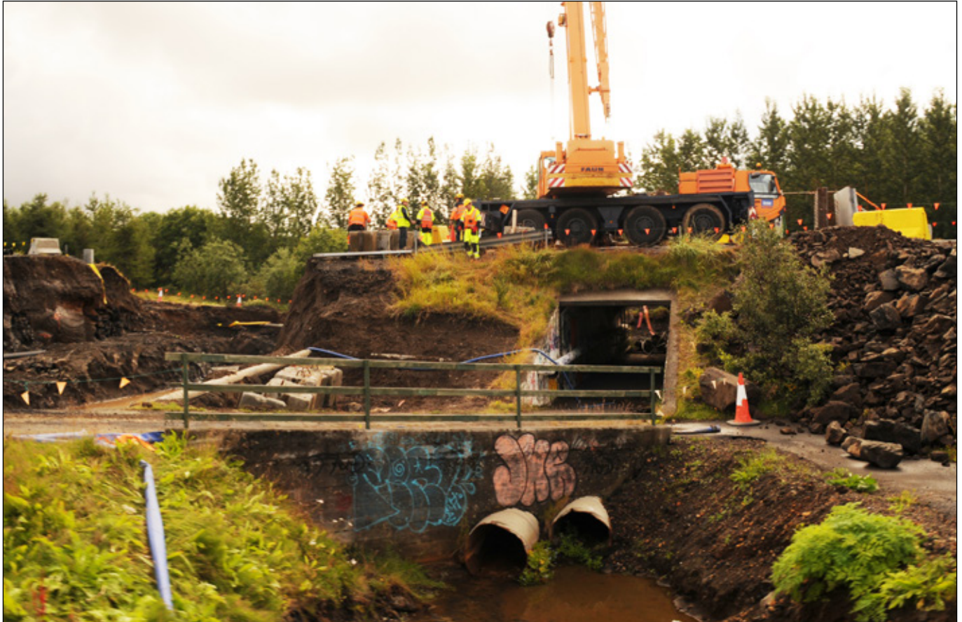
Hringvegur (1), Skarhólabraut - Langitangi. Gerð undirganga við Aðaltún 17. ágúst 2015. Eldri undirgöng voru fjarlægð.
